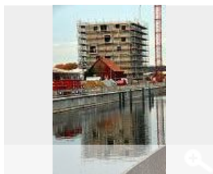
Der künftige Wissenspeicher am Hafen: Der Getreidespeicher musste dafür abgerissen und im gleichen Ausmaß auf Beton wieder aufgebaut werden. Foto: kds
